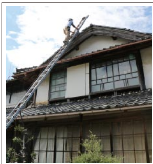
瓦のふき替えでは、自分の目で現場を確認。写真に撮って記録を残す
